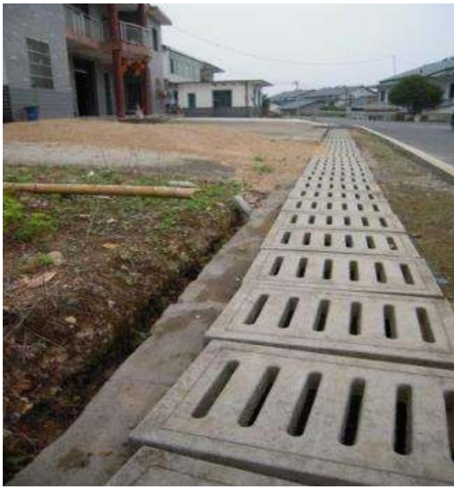
污水收集处理
