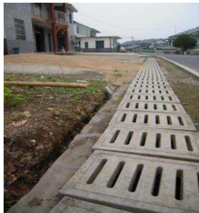
污水收集处理
