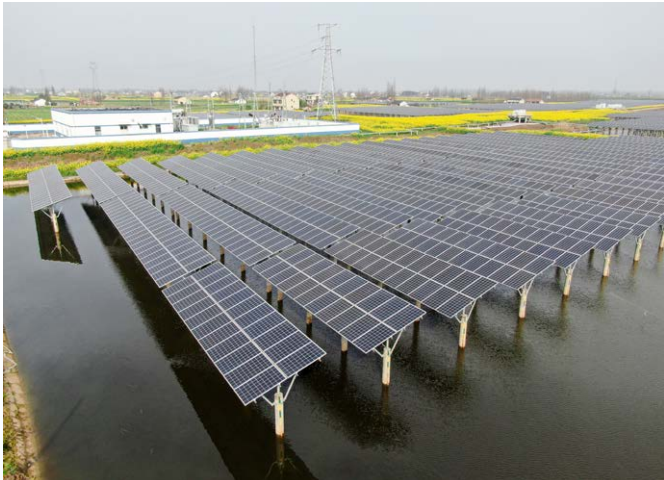
东大光伏 200 兆瓦新能源发电项目
